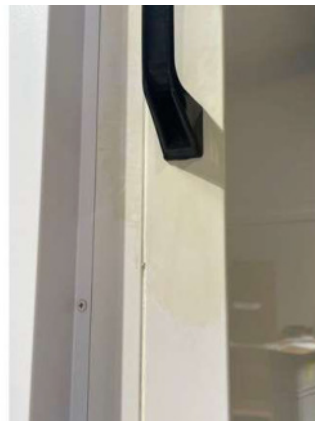
Lackverfärbung an der Rückseite
