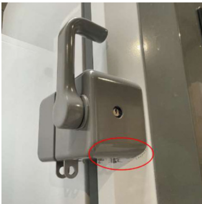
Lackbeschädigung unterhalb des Türgriffes
